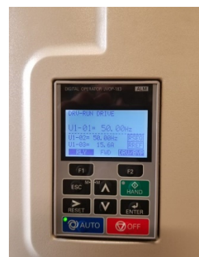
Odor Control Exhaust Fan VFD
